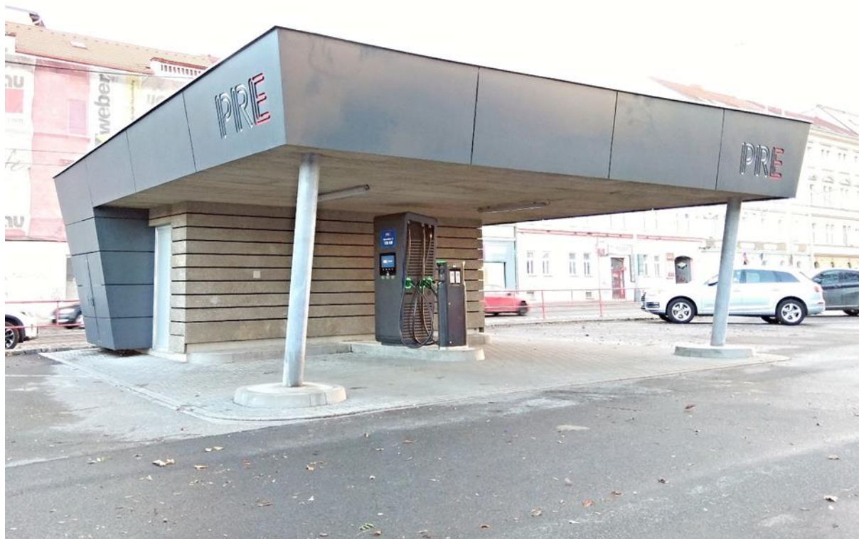
Obr. 3-1 Nabíjecí stanice společnosti PRE v pražských Holešovicích (zdroj: fotoarchiv autora)
